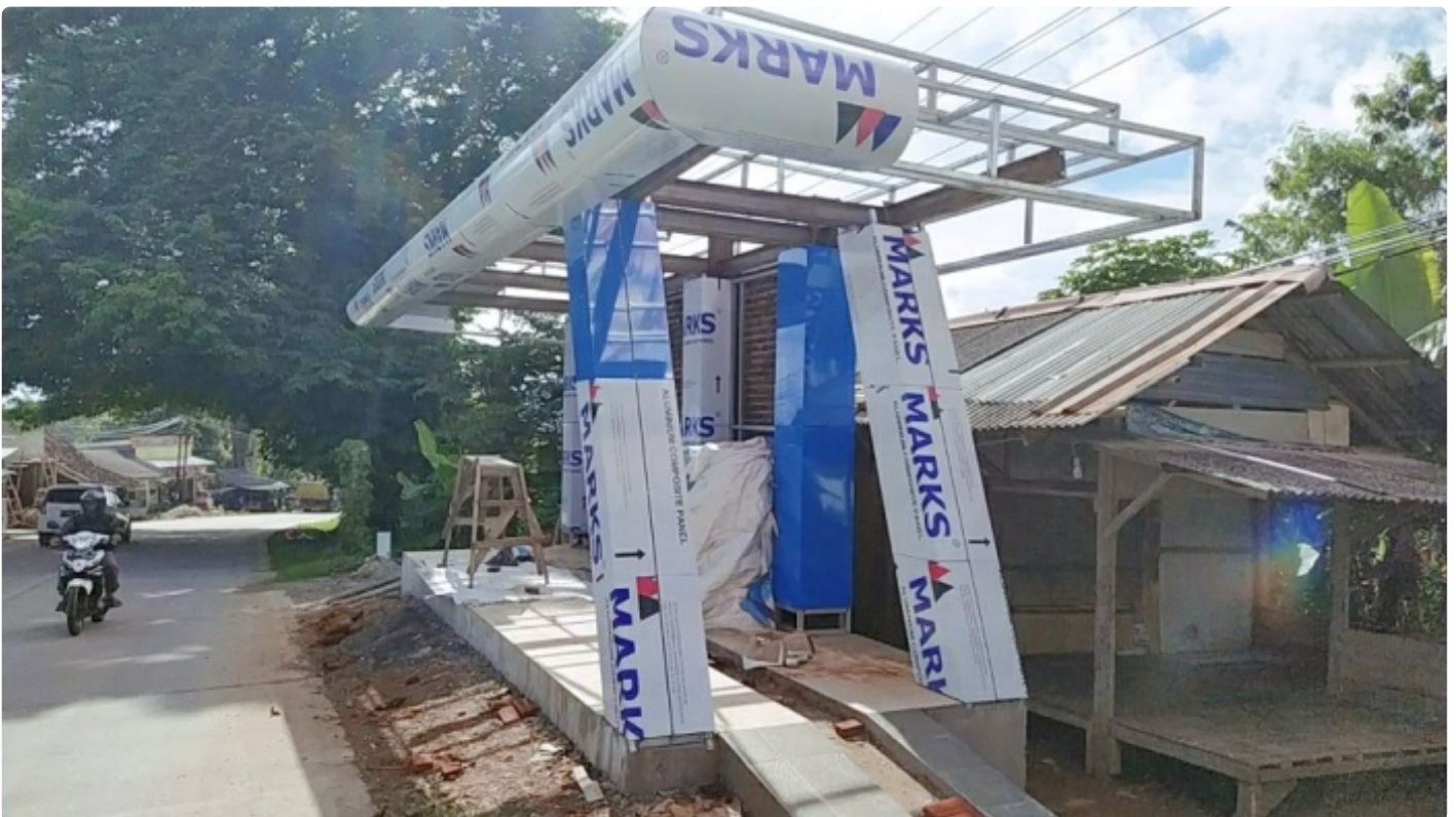
Halte di depan RSUD Malingping yang diduga terlantar pengerjaannya
